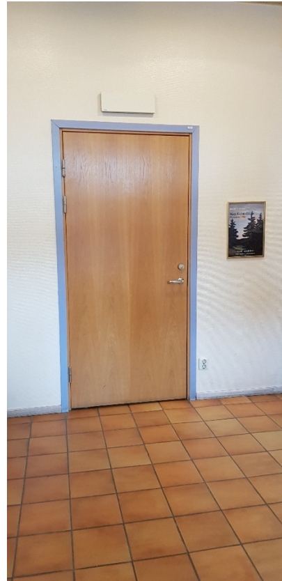
Dörr utan märkning i entré. Är det en toalett? Förråd?
